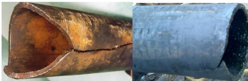
а – разрушение трубы с трещинами; б – разрушение тела трубы
