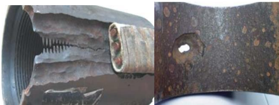
а – разрушение поверхности муфты; б – коррозионные отложения
